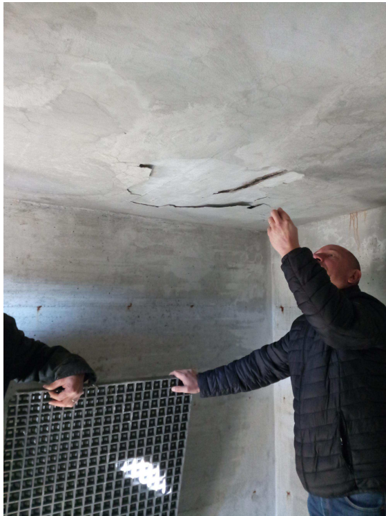
FIGURE 10 – Chambre de captage de S1 : dégradation du revêtement du plafond suite à des infiltrations
