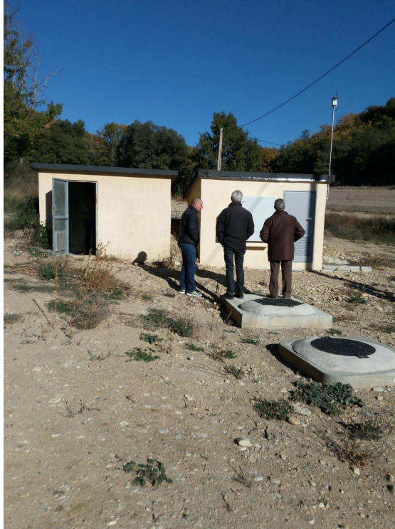
FIGURE 8 – Chambre de captage de S1 (gauche) et S3 (droite), regard de chloration (second plan) et regard vers vanne et compteur (premier plan).
